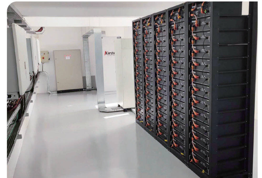
• Brasilien 100kW/307kWh PowerRack HV4 Dynamische Kapazitätserweiterung + PV-Verbrauch
